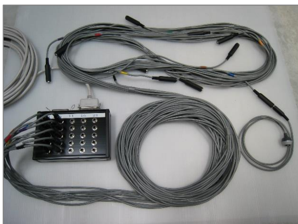
↑ 中継ボックス⇔足元配線コード
