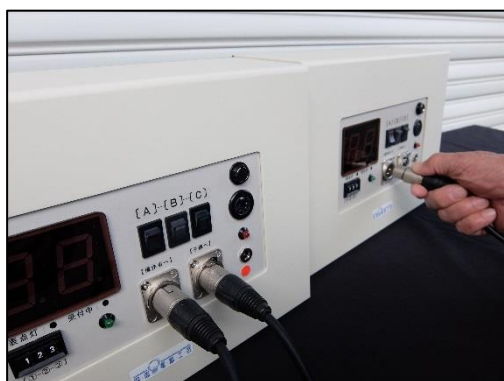
<子機⇄子機間 通信ケーブルの接続>
